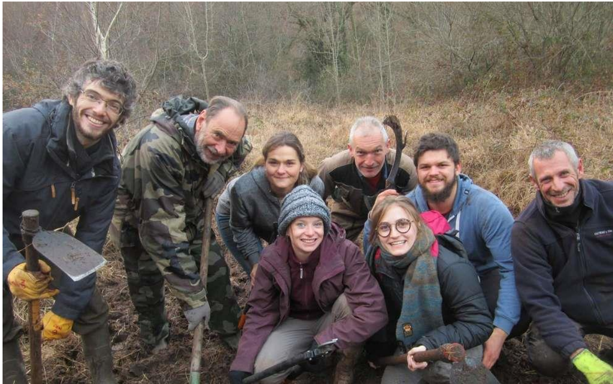
Vincent, Michel, Séverine, Bérénice, Joël, Manon, Kevin, Stéphane (sans oublier Marek, Clément et Franck) devant le chantier de réouverture du milieu.
